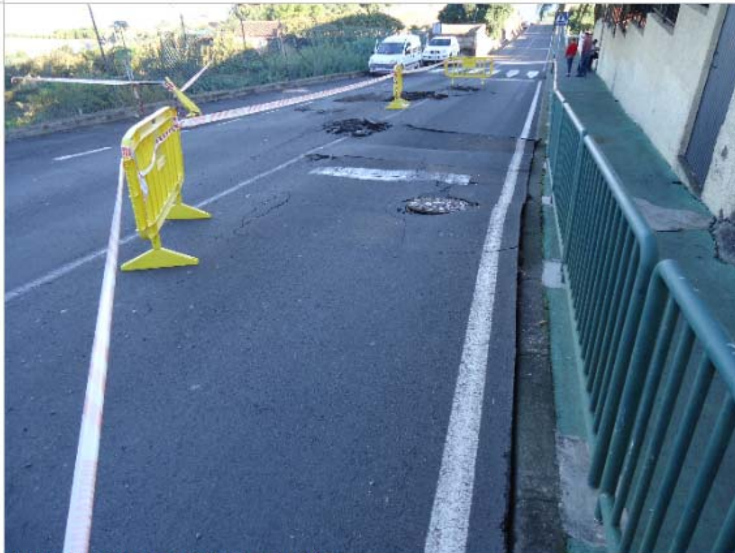
VISTA GENERAL ZONA AFECTADA
