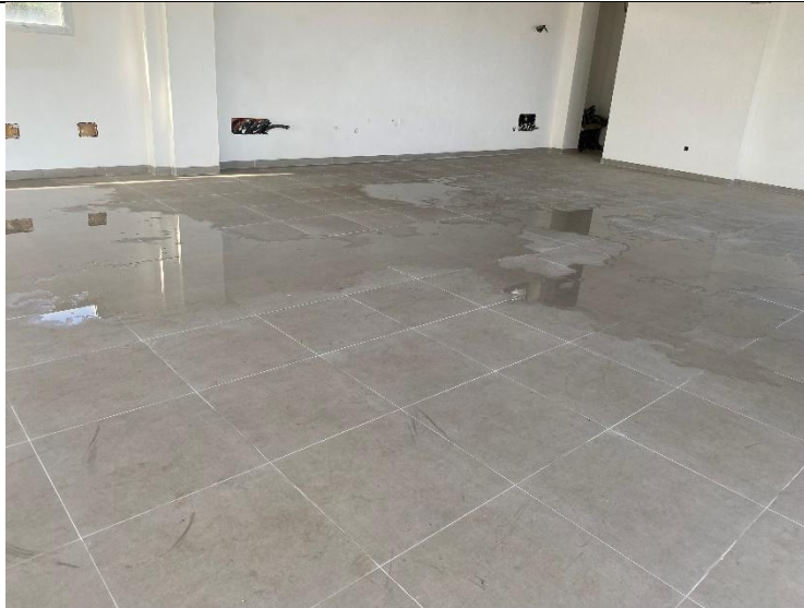
FOTOS CON CHARCOS DE AGUA EN EL PAVIMENTO DE LA CAFETERIA.
