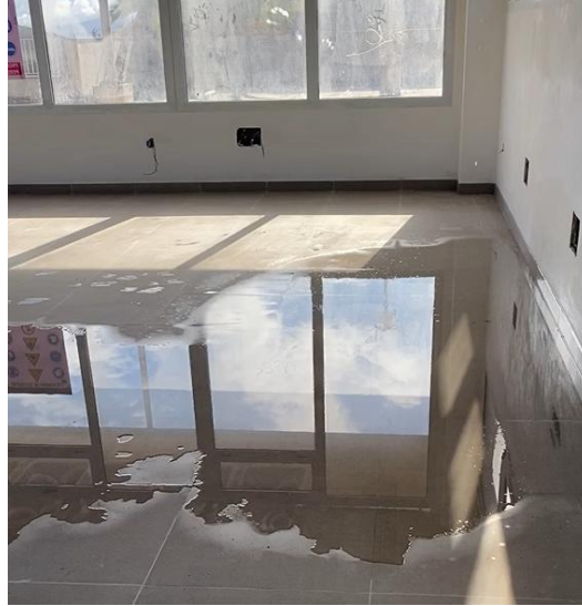
FOTOS CON CHARCOS DE AGUA EN EL PAVIMENTO DE LA CAFETERIA
