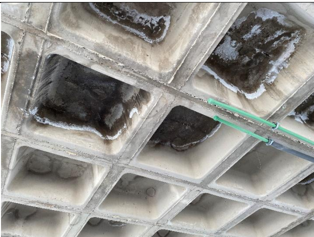
FOTO DE LOS CASETONES DEL FORJADO RETICULAR CON FILTRACIONES DE AGUA DE LA CUBIERTA DE LA CAFETERIA
