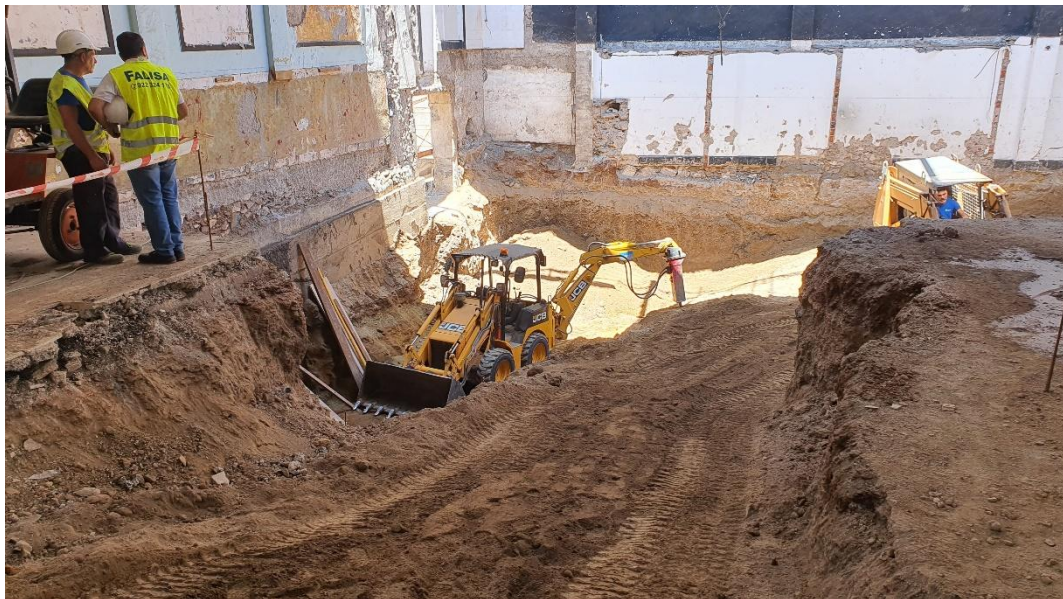
FOTO EN LA QUE SE OBSERVA LA INEXISTENCIA DE ZAPATA EN LA CIMENTACIÓN DEL EDIFICIO EXISTENTE
